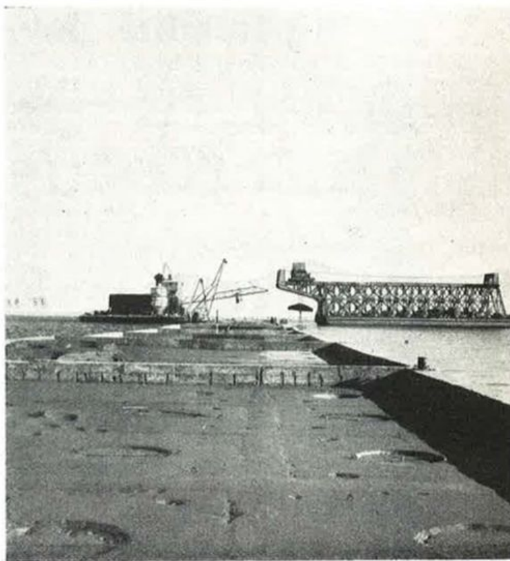
GENOVA: La diga foranea per l'aeroporto di Genova - Sestri in costruzione. A destra si vede il pontone adibito alla posa dei massi, a sinistra la centrale di betonaggio galleggiante. In basso: una veduta panoramica della zona ove si svolgono i lavori per la costruzione del nuovo aeroporto
