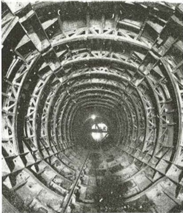
Armatura della galleria per il getto del rivestimento in calcestruzzo, per l'impianto idroelettrico di S. Floriano. Per il completamento dei lavori di costruzione di detto impianto l'I.N.A. ha concesso un mutuo di L. 1 miliardo e 500 milioni alla società Avisio
