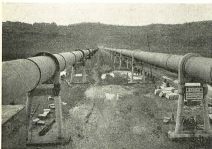
Doppia condotta in acciaio per l'attraversamento della depressione tibetina, vista dalla stazione di Poggio Mirteto.
