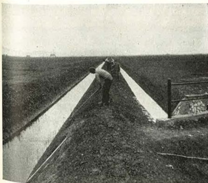
Una visuale su due canali di scolo costruiti nella zona della bonifica
