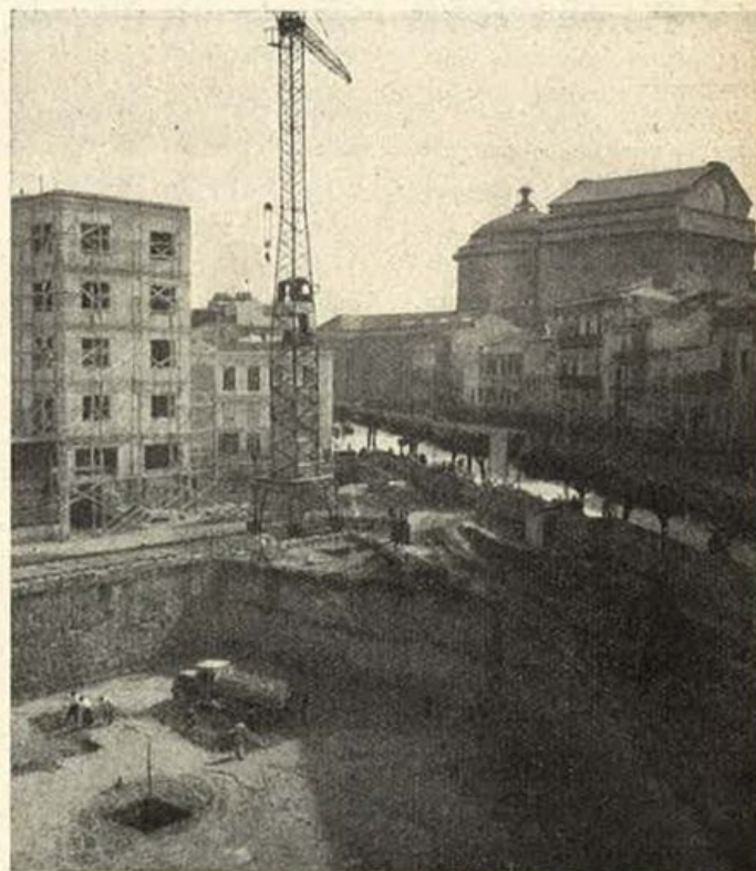
L'inizio dei lavori del grattacielo di Palermo - Sullo sfondo si profila il teatro Massimo di Palermo.
