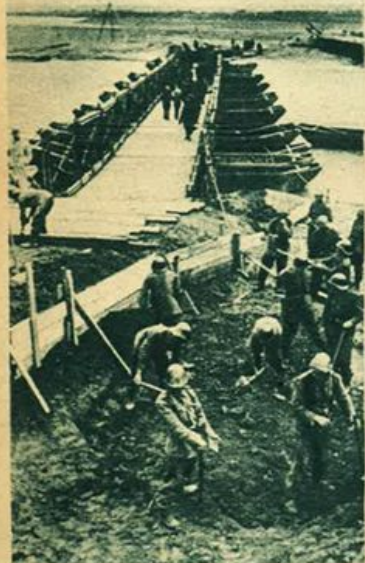
Fronte meridionale. Un ponte gettato sul Prut dai genieri romeni. (Foto A. F. L.)
